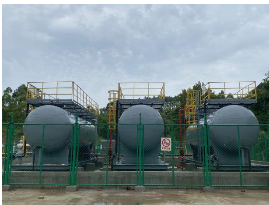
污水罐及围堰
